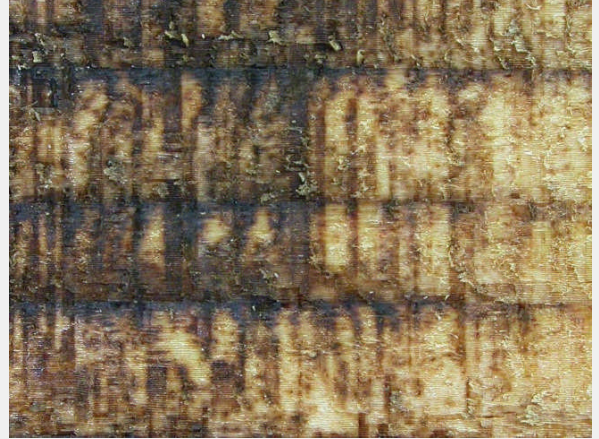
Befallsmerkmale am Holz
